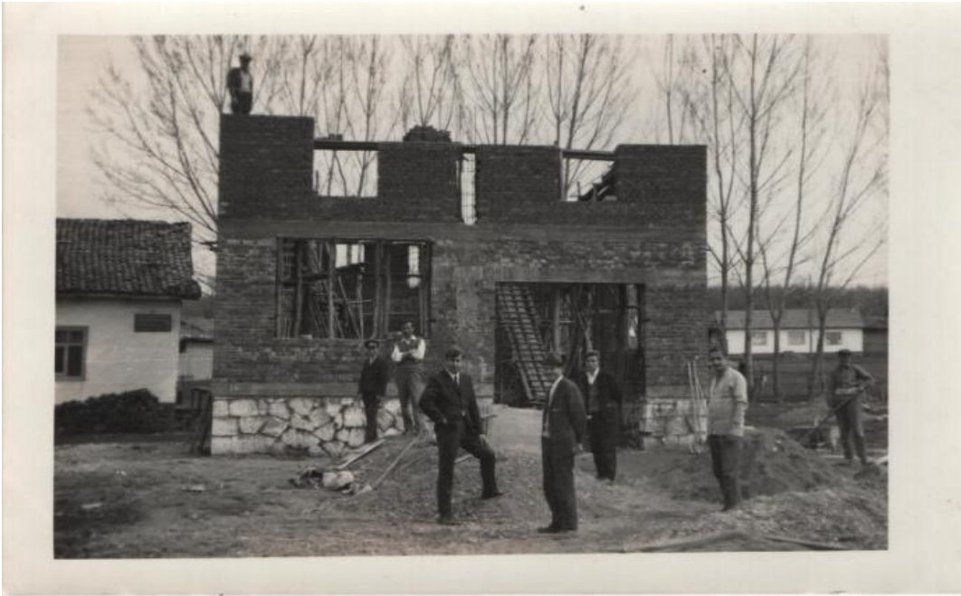
FOTOĞRAF 22- Kınık Köyü Kalkınma Kooperatifi tarafından yapılan modern un değirmeni inşaatı. Kooperatif Yöneticileri ve ustalar. (1970) Necmi TEKİN arşivi
