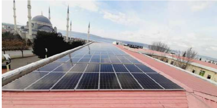
Şekil 102. Çanakkale Onsekiz Mart Üniversitesi'nde güneş enerjisi sadece Terzioğlu Yerleşkesi Çocuklar Evi Çatısı
