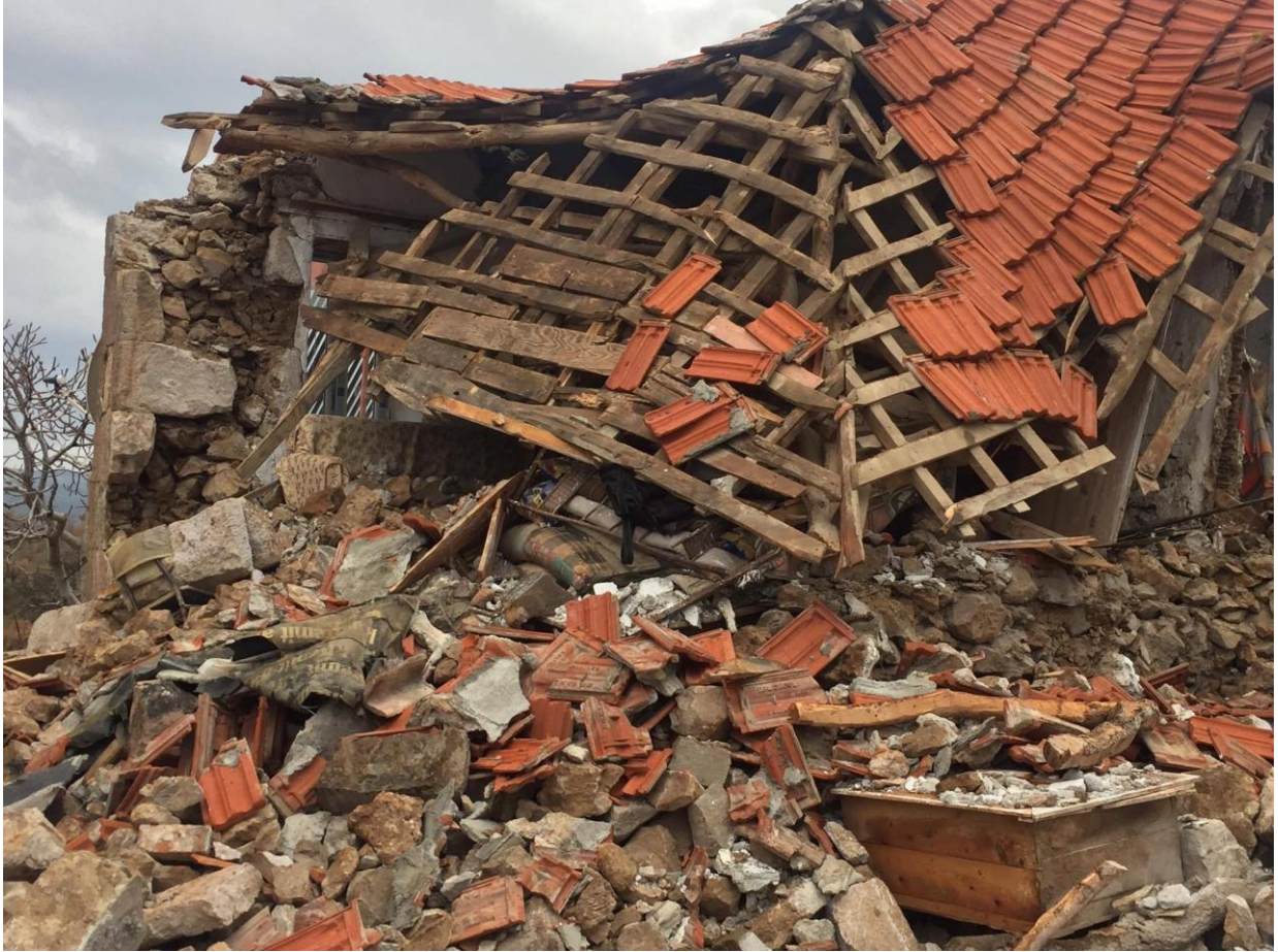
Resim 1: Çamköy'de Yıkılmış Bir Ev, (Ayvacık Depremi, 07 Şubat 2017)
